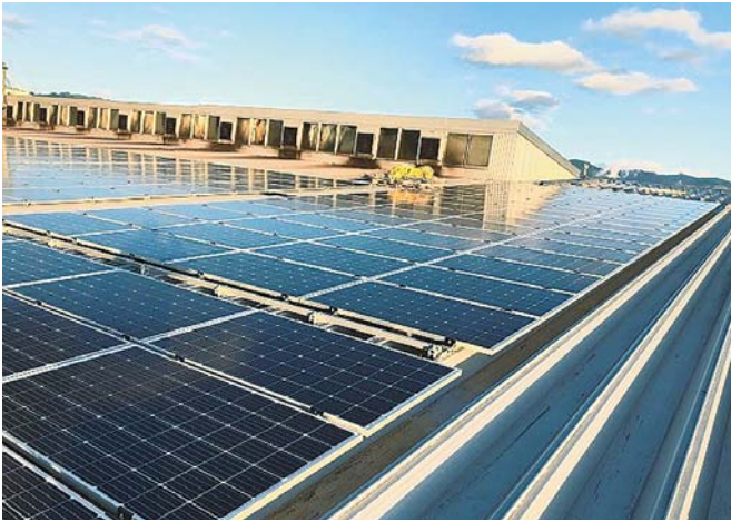
自家消費型太陽光発電 工場屋根の施工事例564.0kW (滋賀県)
